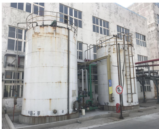
丙烯酰胺储罐
